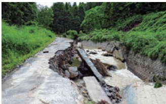
平成30年度最上地域豪雨災害 (舟形町堀内川)
